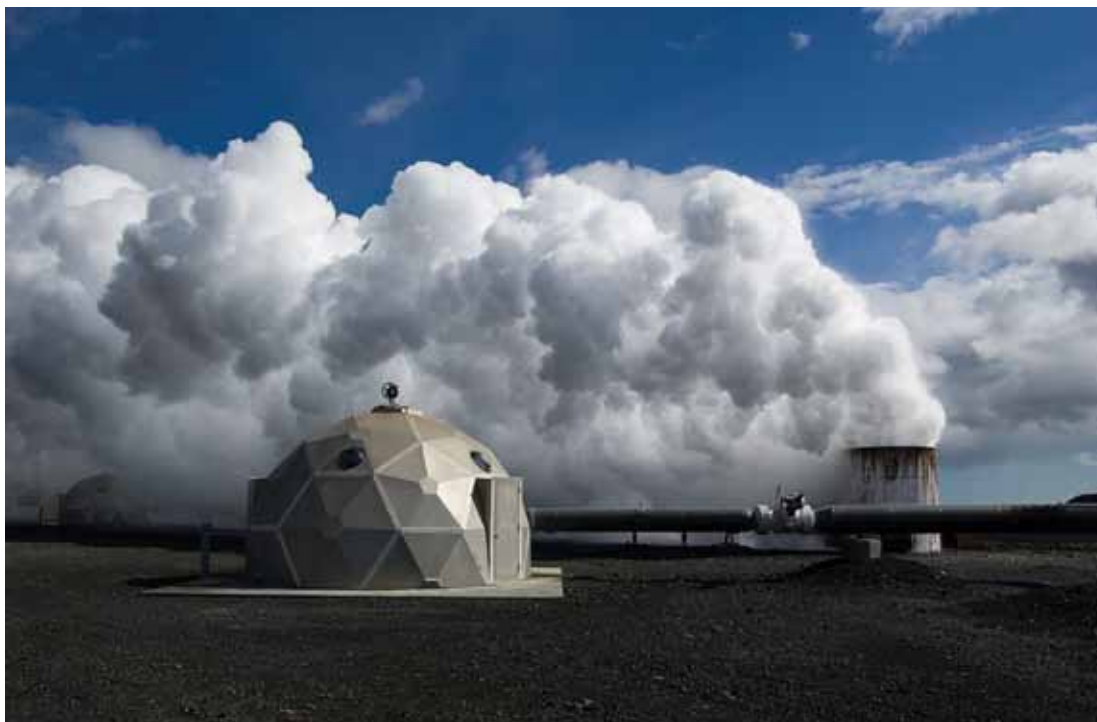
FIGURE 2.4 Tête de puits géothermique et silencieux
